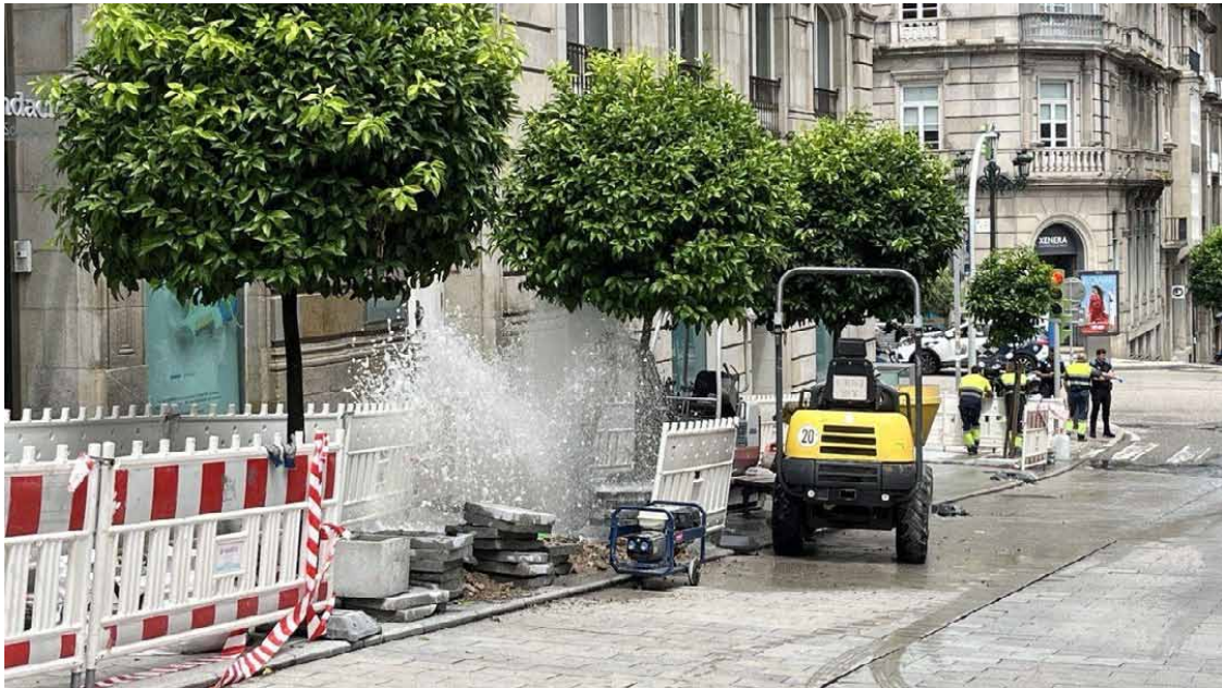
photo_camera El agua saliendo con fuerza debido a una fuga en Velázquez Moreno.
